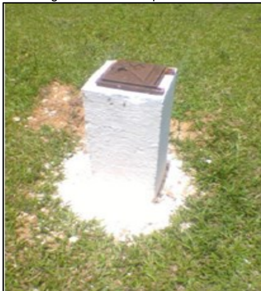
Figura 78 – Poço nº 4 de água subterrânea para fins de monitoramento ambiental.
