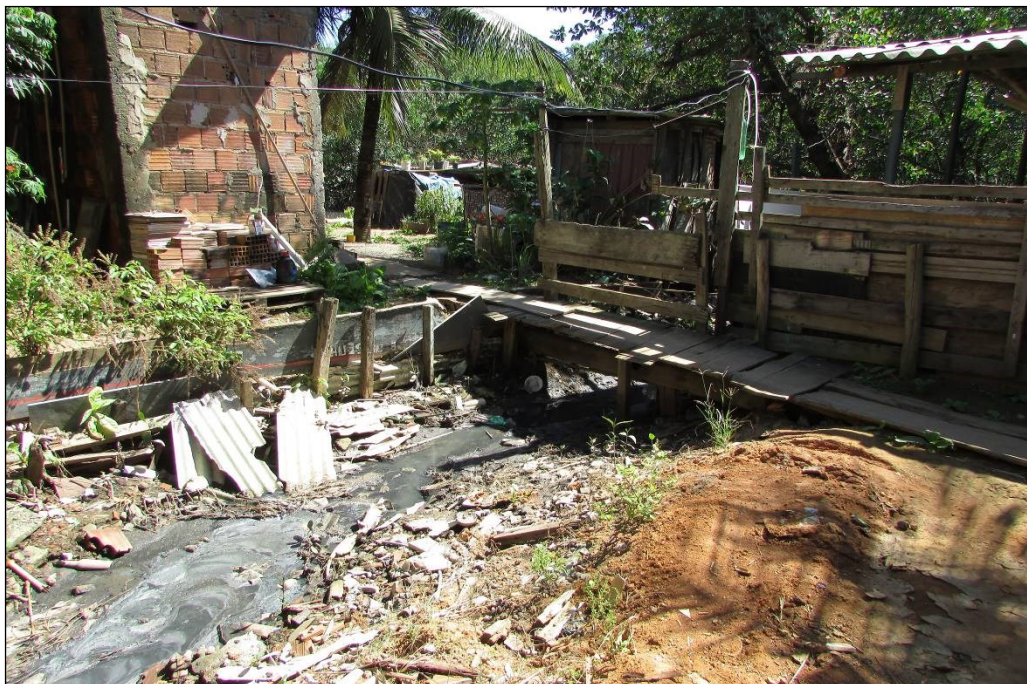
Foto 03 – Imagem de um pontilhão sobre o Rio Itanguá com evidente aterro irregular promovendo o estreitamento da calha do rio.
